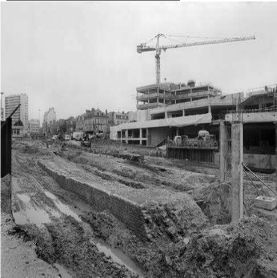
Vue du parement interne de la courtine située sur le front entre les portes Saint-Vincent et Saint-Paul, découvert en 1987 lors des travaux d'aménagement des boulevards de Verdun et Alexandre-Martin
